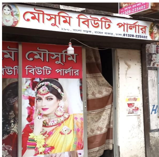
Fig 4.11. মৌসুমি বিউটি পার্লার ( Mousumi Beauty Parlor in Rayrebazar, Deteriorating Wall )
