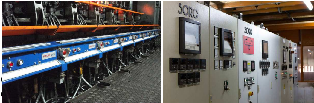
Fig 2.1.4 : Annealing Lehr & Furnace Control Room
